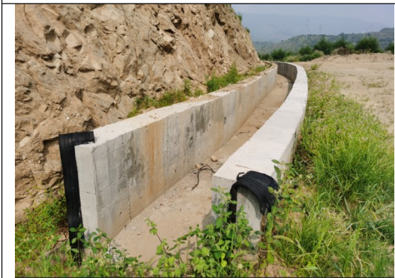
固废处理场右岸截洪沟已建
