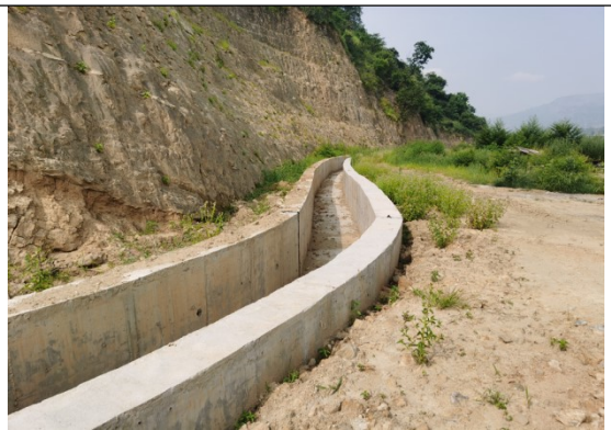
固废处理场右岸截洪沟已建
